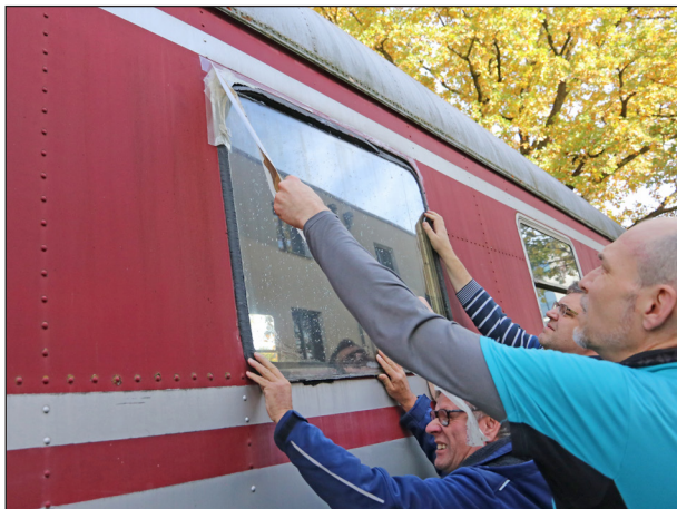
Mit vereinten Kräften wurde das provisorisch angebrachte Klebeband entfernt und die Scheibe demontiert.
