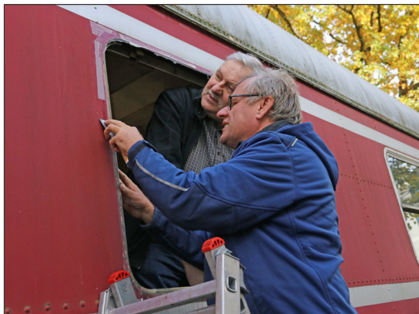
Nachdem Scheibe und Dichtung entfernt waren, mussten die Reste der Dichtung vom Fensterrahmen entfernt werden. Fotos (2): Klaus Probst
