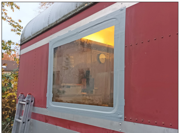
Der aktuelle Zwischenstand mit wiederum provisorisch montierter, jedoch jetzt gegen Absturz gesicherten Scheibe. Foto: Michael Mrugalla
